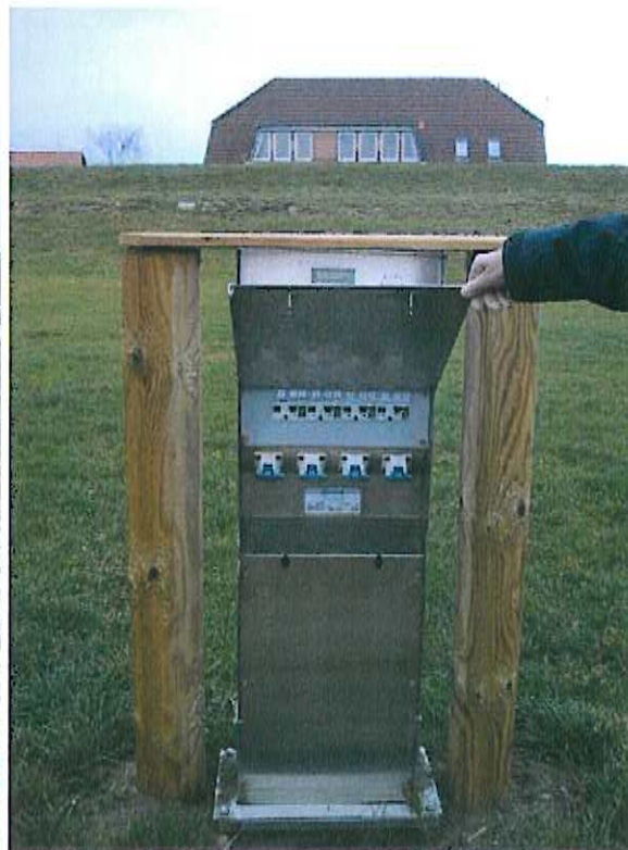
Abb. 4 Ansicht auf eine Stromversorgungssäule - davon sind bereits 8 Stück vorhanden (P. Scharlibbe 02.12.2011)
